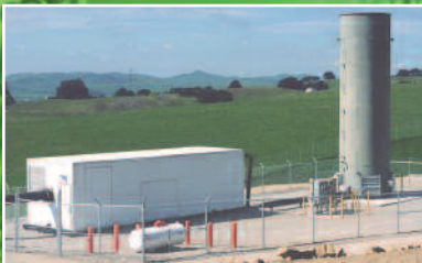
BIOGAS VAPOR CONTROL
